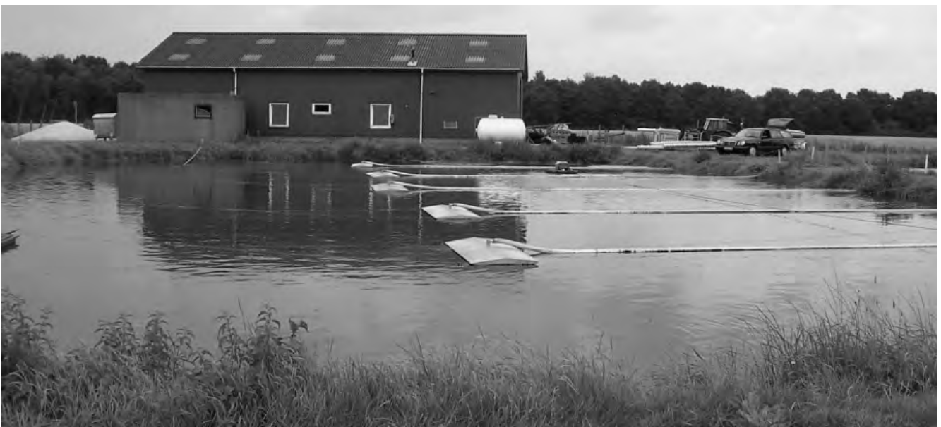
Vaale, Linienbelüfter auf der Kläranlage
