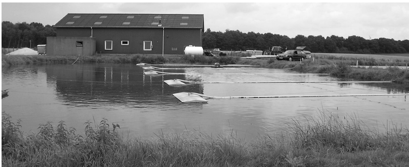
Vaale, Linienbelüfter auf der Kläranlage
